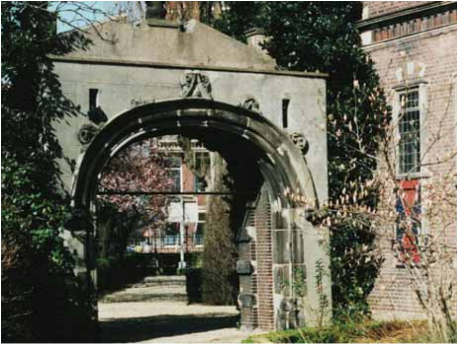
Aanvullende reparaties met te harde specie in de boog van de poort van de Duitse ridderorde uit Utrecht, tuin Rijksmuseum.
