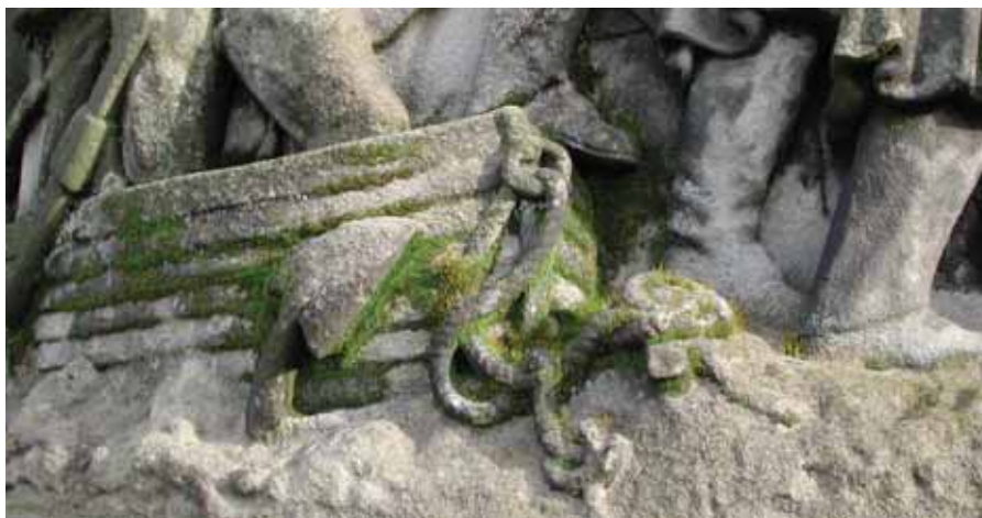
Jarenlange verwaarlozing van de grootste huldeblijk aan de stichting van het Koninkrijk der Nederlanden: Het Nationale Gedenkteken op Plein 1813 in Den Haag. Opgericht in 1869, gerestaureerd in 2004. Foto: Rob Crèvecoeur.
